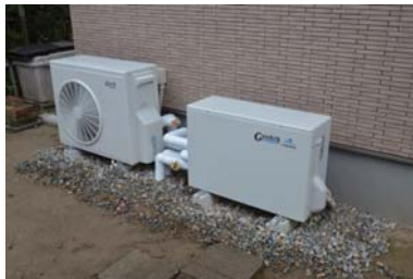
ヒートポンプ(地中熱+空気熱)
