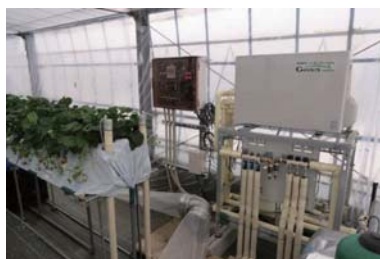
ヒートポンプ
