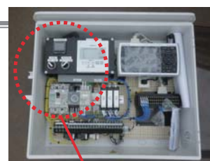
受電・制御・計装盤
