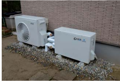
ヒートポンプ(地中熱+空気熱)
