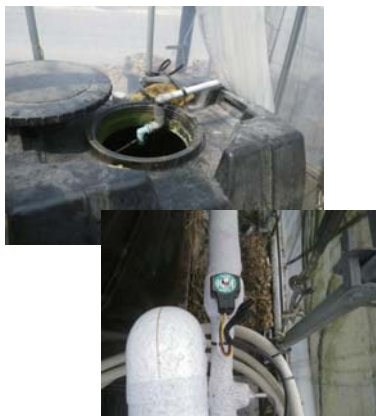
既設井戸系統配管と電磁弁
