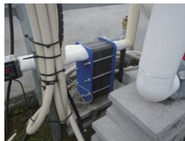
小型プレート式熱交換器 (地下水とヒートポンプを分離)
