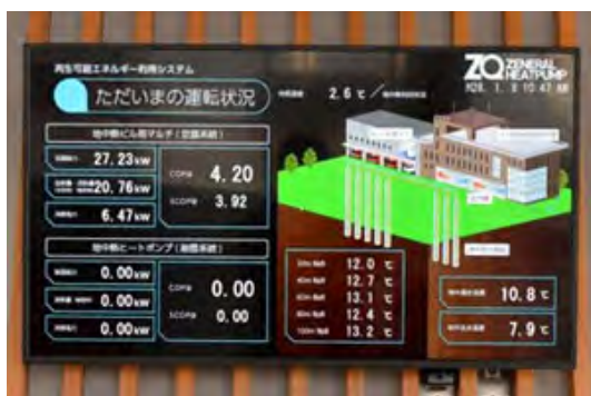
【融雪・空調】十日町地域消防本部
